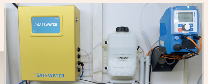
Zentral implementiert versorgt SAFEWATER sämtliche Entnahmestellen der Trinkwasserinstallation der Praxis.
